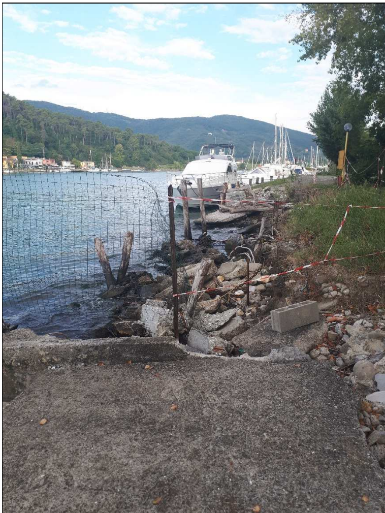
Fotografia n. 4: Vista controcampo della sponda e della banchina di ormeggio interessate dalle opere di manutenzione straordinaria, ripristino e ristrutturazione. Nella ripresa fotografica si vedono chiaramente gli svuotamenti prodotti dall'erosione del fiume Magra e dall'azione del mare.
