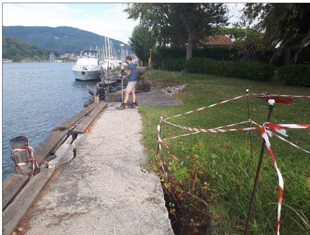
Fotografia n. 6: Altra vista della sponda da valle della concessione demaniale interessata dalle opere di manutenzione, ripristino e ristrutturazione.
