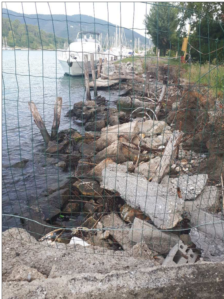
Fotografia n. 5: Vista di dettaglio della sponda e della banchina di ormeggio interessate dalle opere di manutenzione straordinaria e ripristino. Nella ripresa fotografica si vedono chiaramente gli svuotamenti prodotti dall'erosione del fiume Magra e la precedente linea spondale costituita dai pali rimasti in acqua. In acqua attualmente troviamo anche le rimanenze della banchina precedente che sarà rimossa prima della posa della nuova palancolata.
